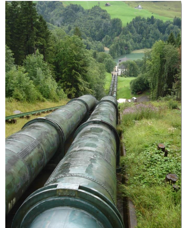
Druckleitung KW Wägital
