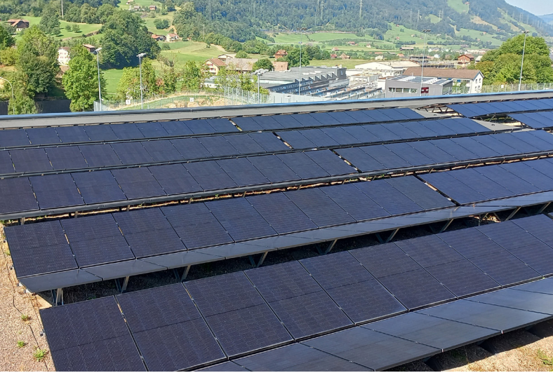
PV-Anlage auf dem Schul- und Sportgebäude Allmig in Oberarth.
